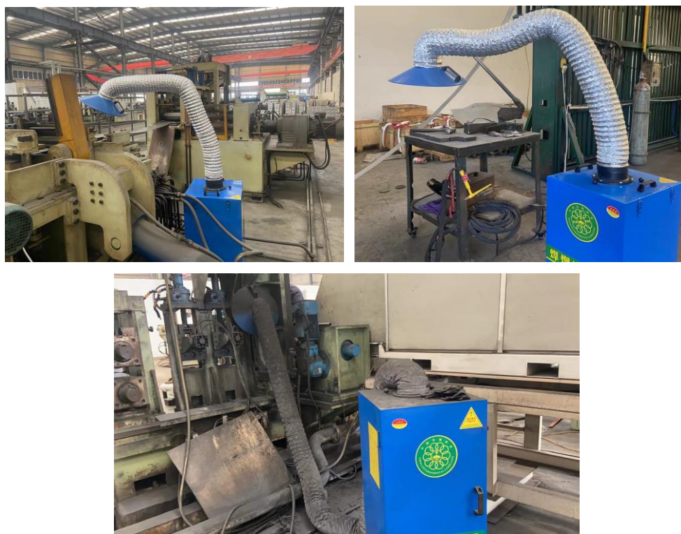
图 3-1 废气处理设施
