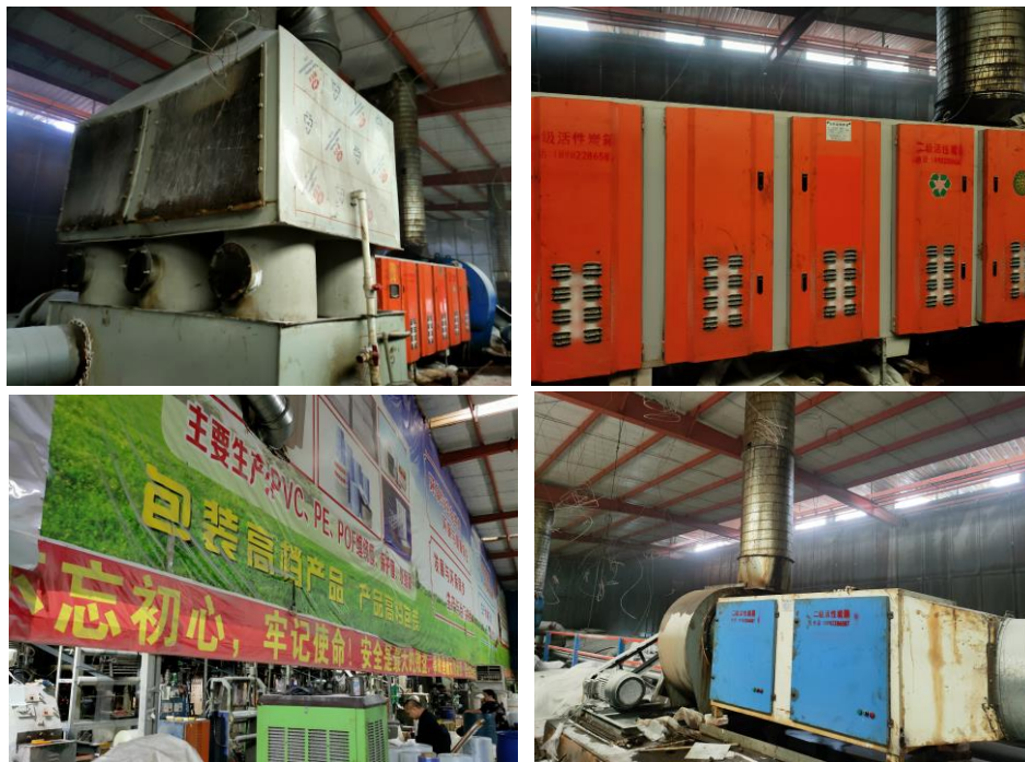
图 3-1 废气处理设施
