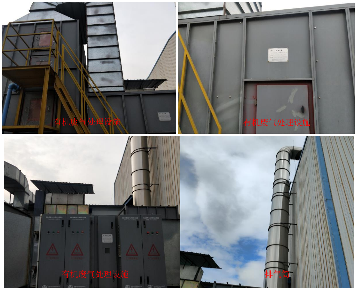
图 3-1 废气处理设施
